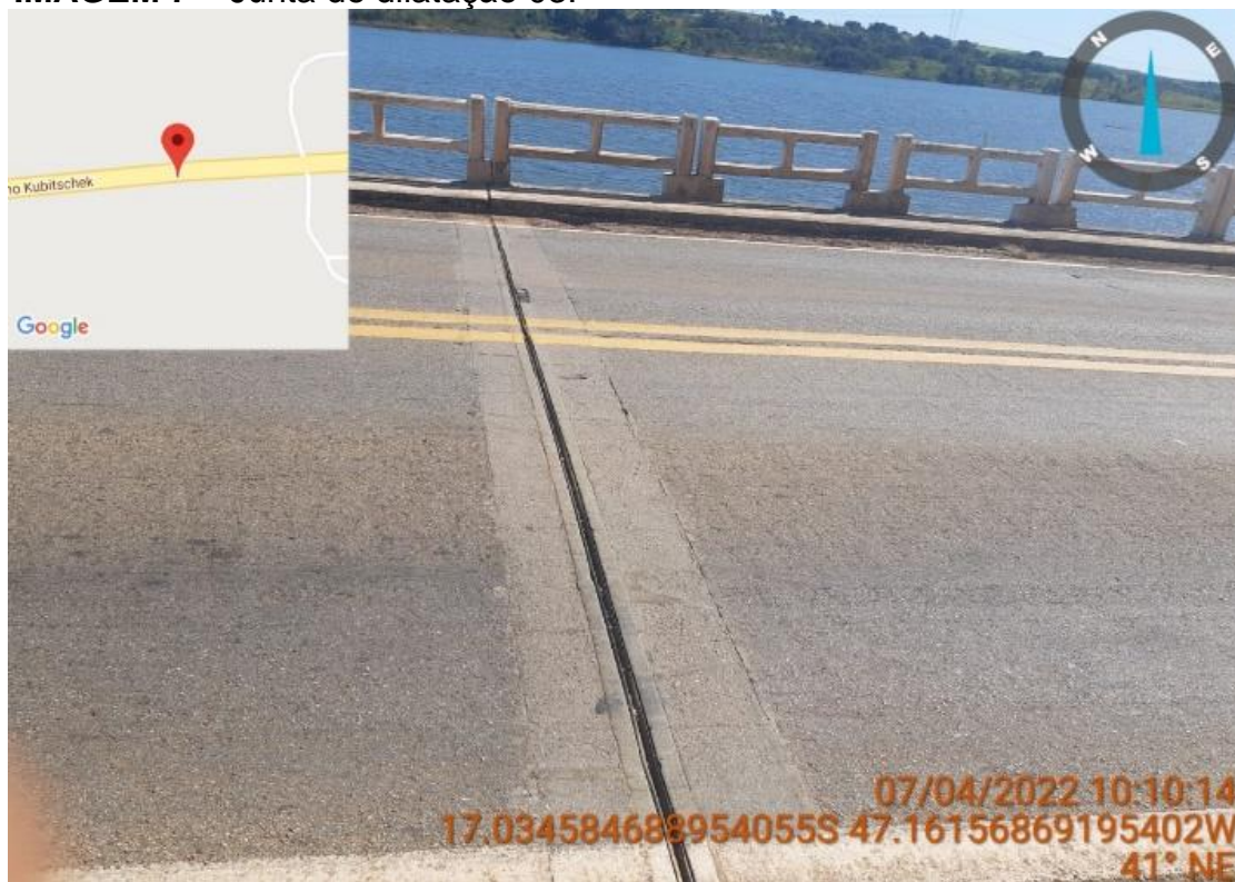
IMAGEM 7 – Junta de dilatação 03.
