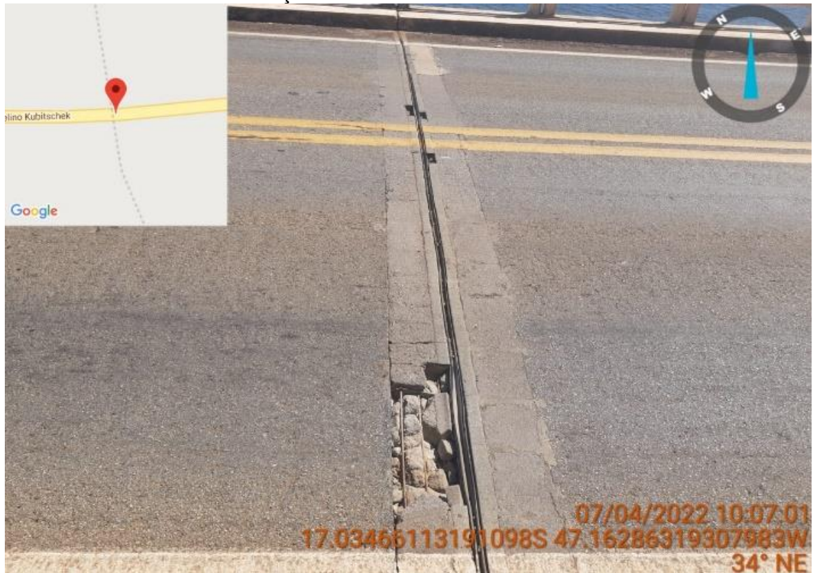
IMAGEM 8 – Junta de dilatação 04.
