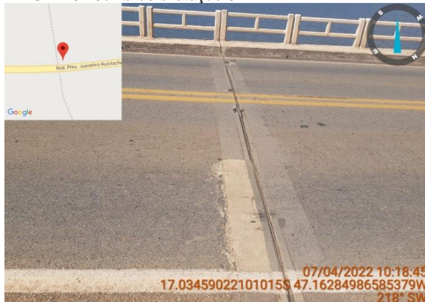
IMAGEM 5 - Junta de dilatação 01.
