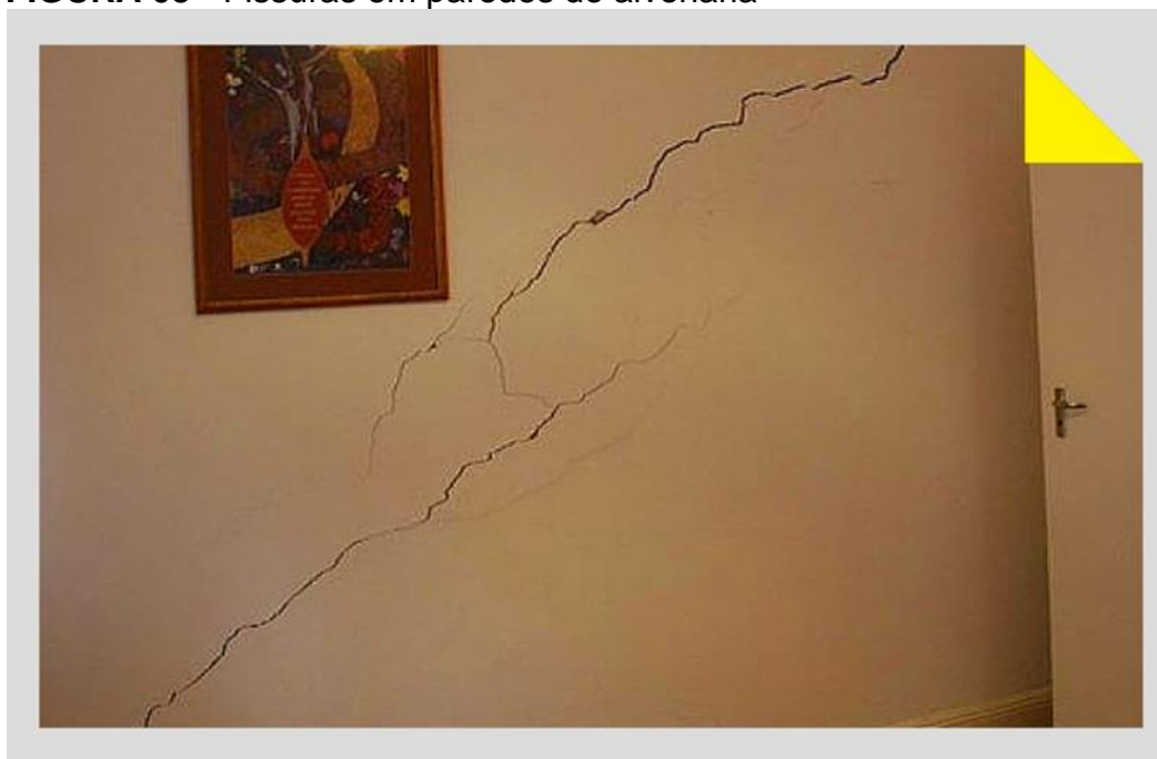
FIGURA 05 - Fissuras em paredes de alvenaria
