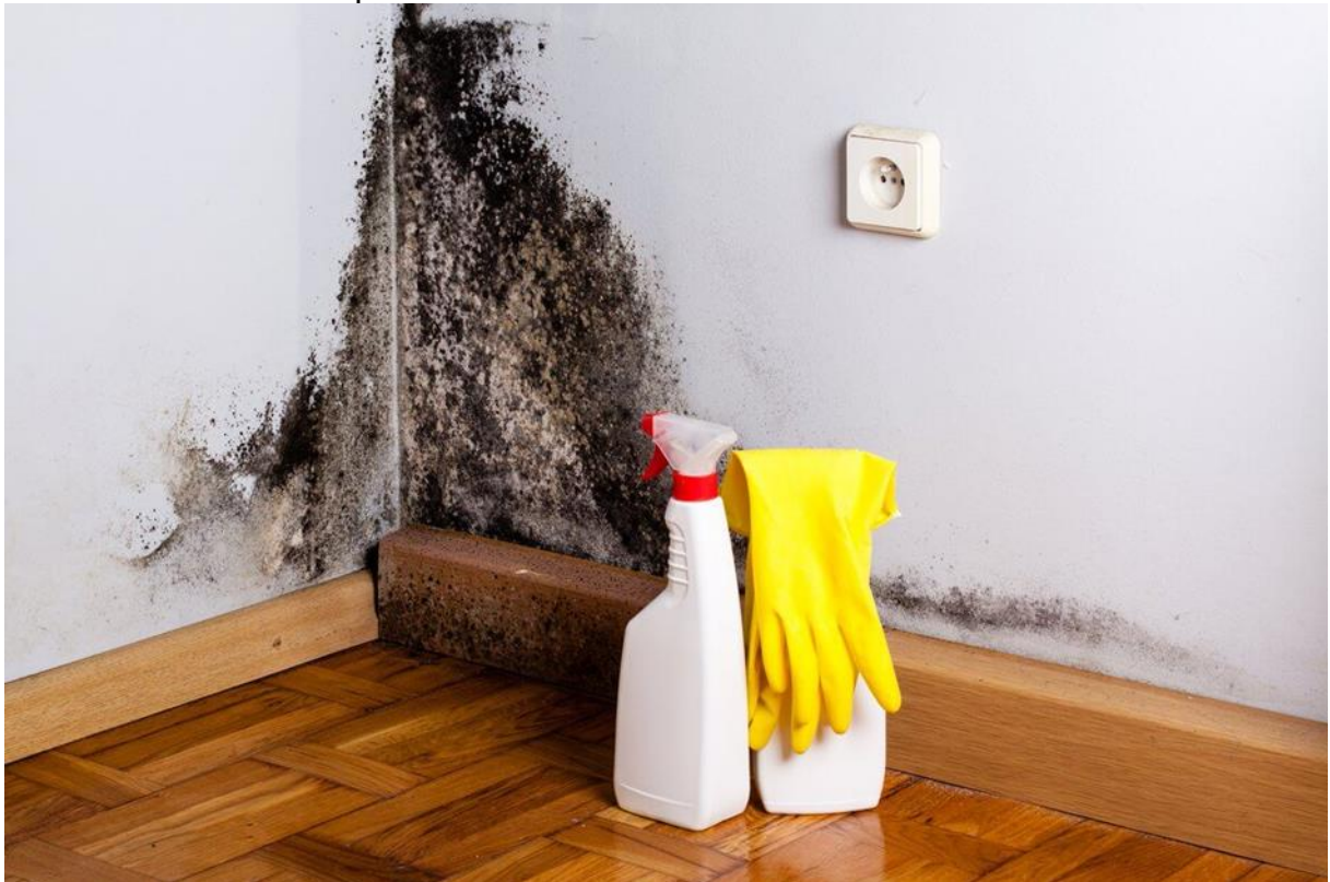
FIGURA 03 - Mofo em paredes
