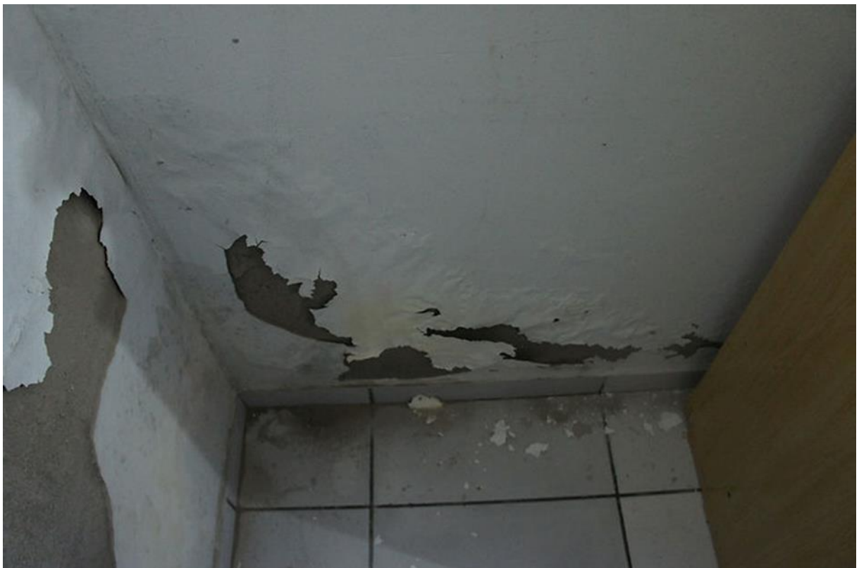
FIGURA 04 - Umidade, deterioração do reboco e da pintura
