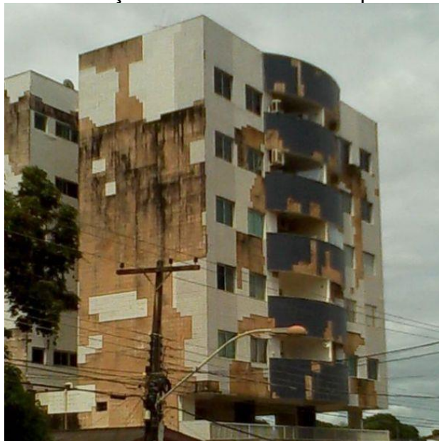
FIGURA 2: Infiltração e descolamento em parede externa
