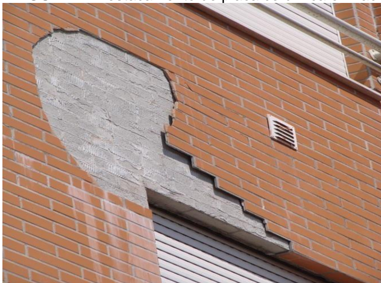
FIGURA 4: Destacamento de placa cerâmica em fachada
