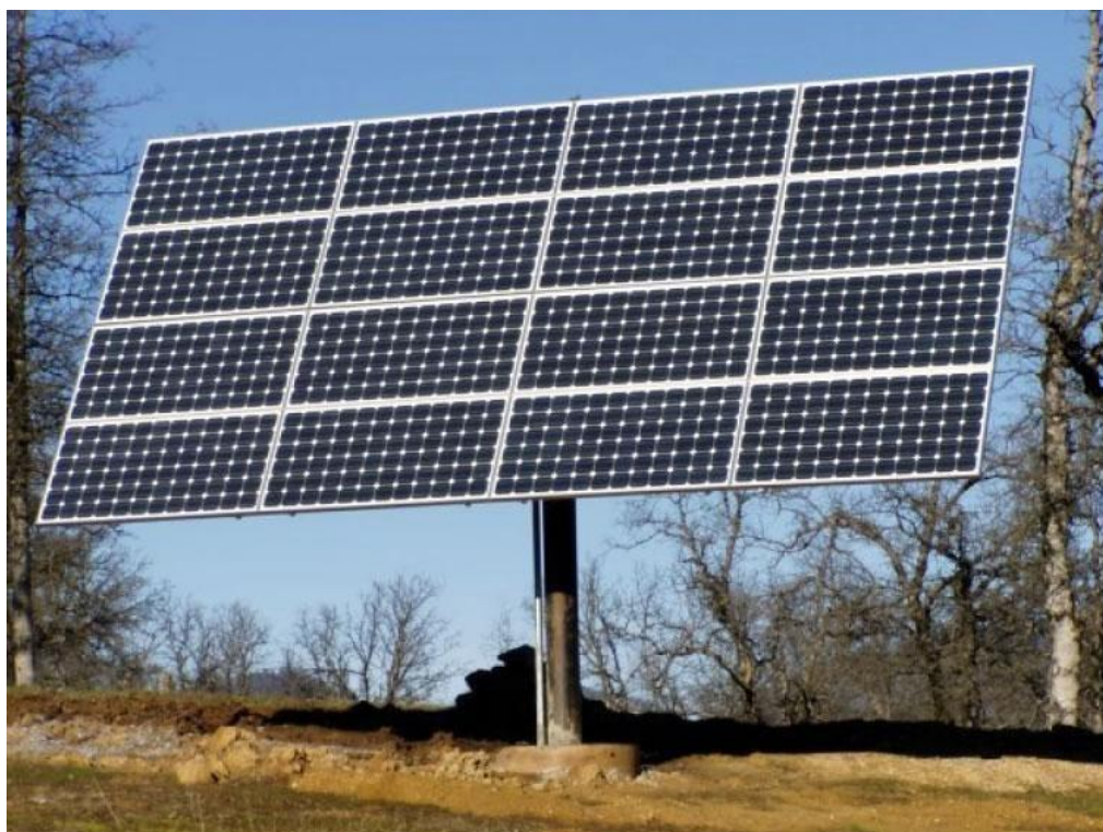
FIGURA 4: Rastreador Solar Fotovoltaico – Wattsun Solar Tracker AZ-125
