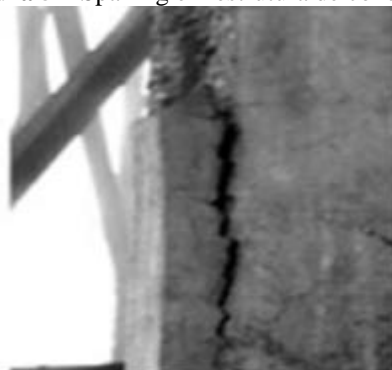
Figura 5 – Spalling em estrutura de concreto.
