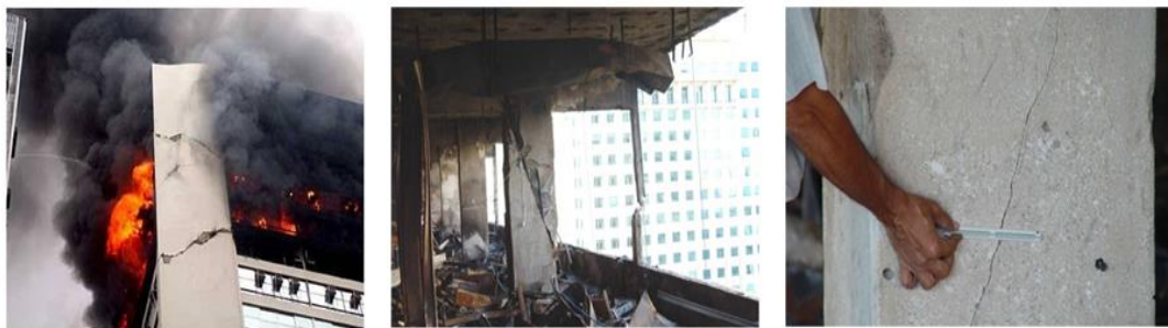
Figura 3 - Pilares e vigas em concreto armado comprometido após incêndio.
