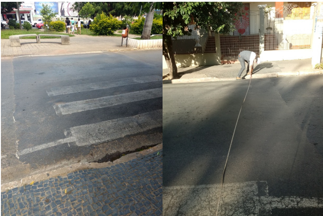
Figura 13- Praça Major Mendonça, local de manutenção.
