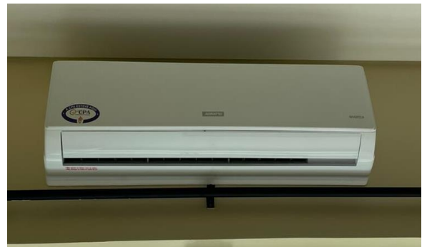
Ar condicionado - lab. Habilidades
