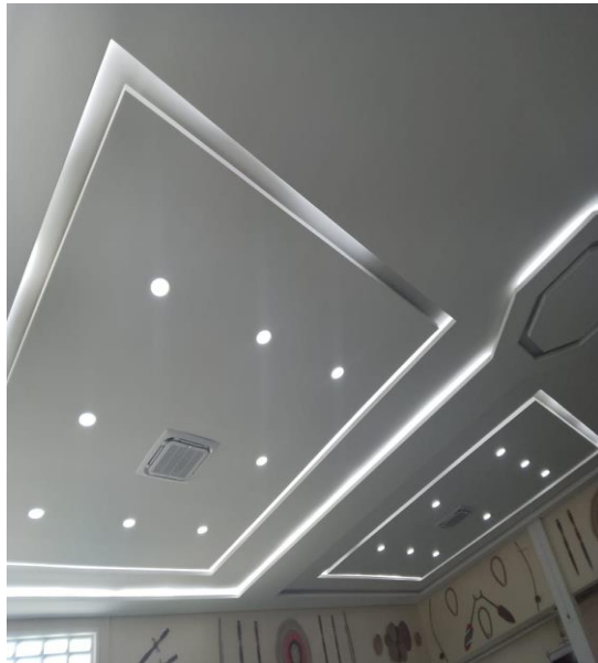
Climatização da praça de alimentação
